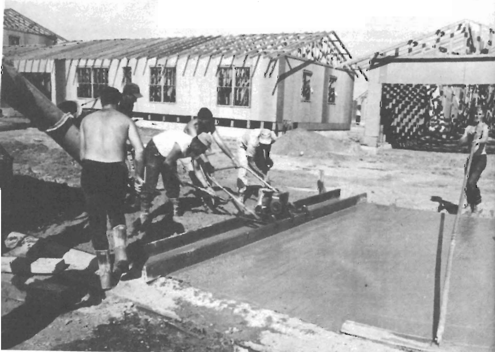
Seriesproduktion av betongplattor vid tillfarten till garaget. Inte mindre än 32 plattor finner lagret med under en arbetsdag.
